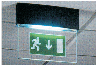
Alumbrado de señalización y emergencia
