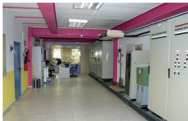
► Sala de control planta de cogeneración y calderas de apoyo.
